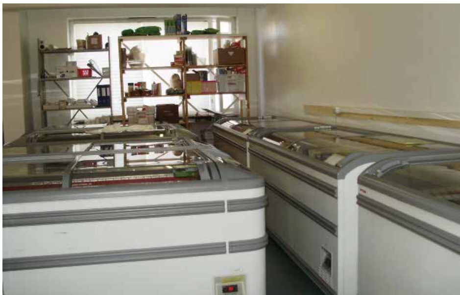
Vuoden vaihteessa uusittiin kylmälaitteet Lidlin avustuksella.
